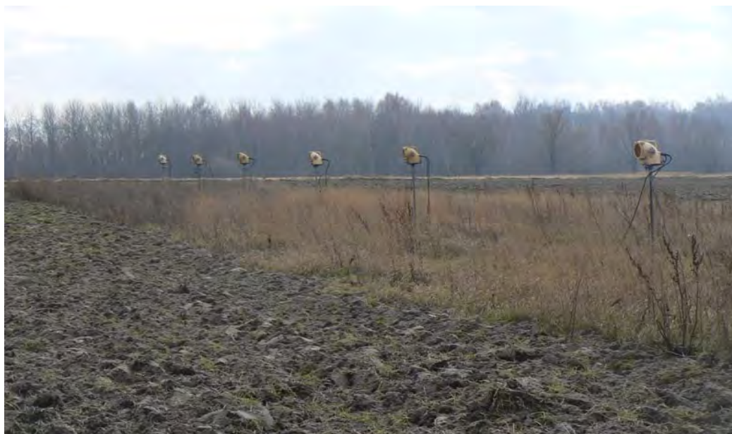
Fot. 23. Budowa elementów i otoczenie systemu świetlnego ŁUCZ-2MU zamontowanego na lotnisku wojskowym
