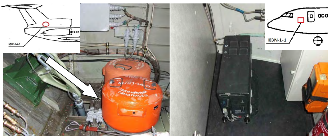
Rys. 10. Miejsce zamontowania rejestratora katastroficznego MŁP-14-5 w ochronnej obudowie (zdjęcie z lewej strony) i KBN-1-1 (zdjęcie z prawej strony)
